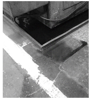
图 4 加工车间地面污染状况
